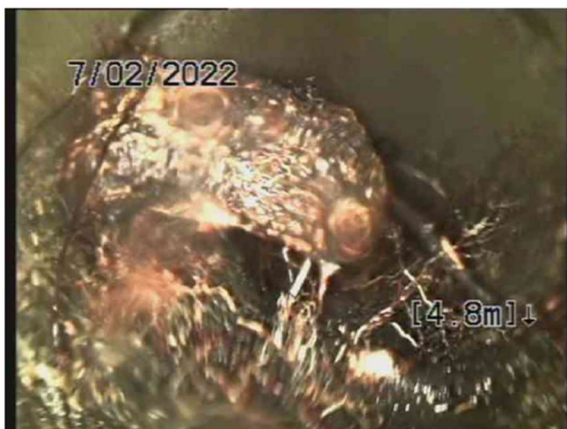
1-1-7A, 00:01:17, 4.81m Inspection abandonnée / , la caméra ne passe pas
