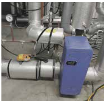
Echangeur de chaleur.
